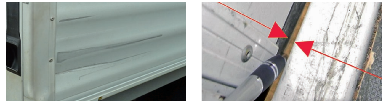
Verformungen in den Schienen, die auf wirtschaftliche Weise repariert werden können, Schließung nicht möglich oder nicht sanddicht
