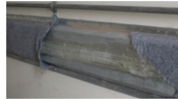
Polsterung und Stangen: Teppich gerissen oder abgelöst
