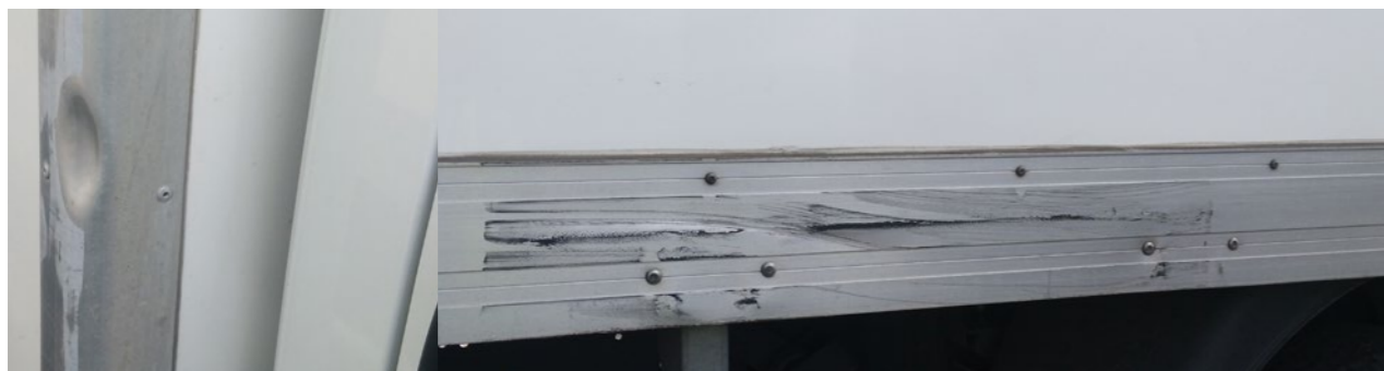
Unterboden-Seitenprofile: Verformungen, die auf wirtschaftliche Weise repariert werden können
