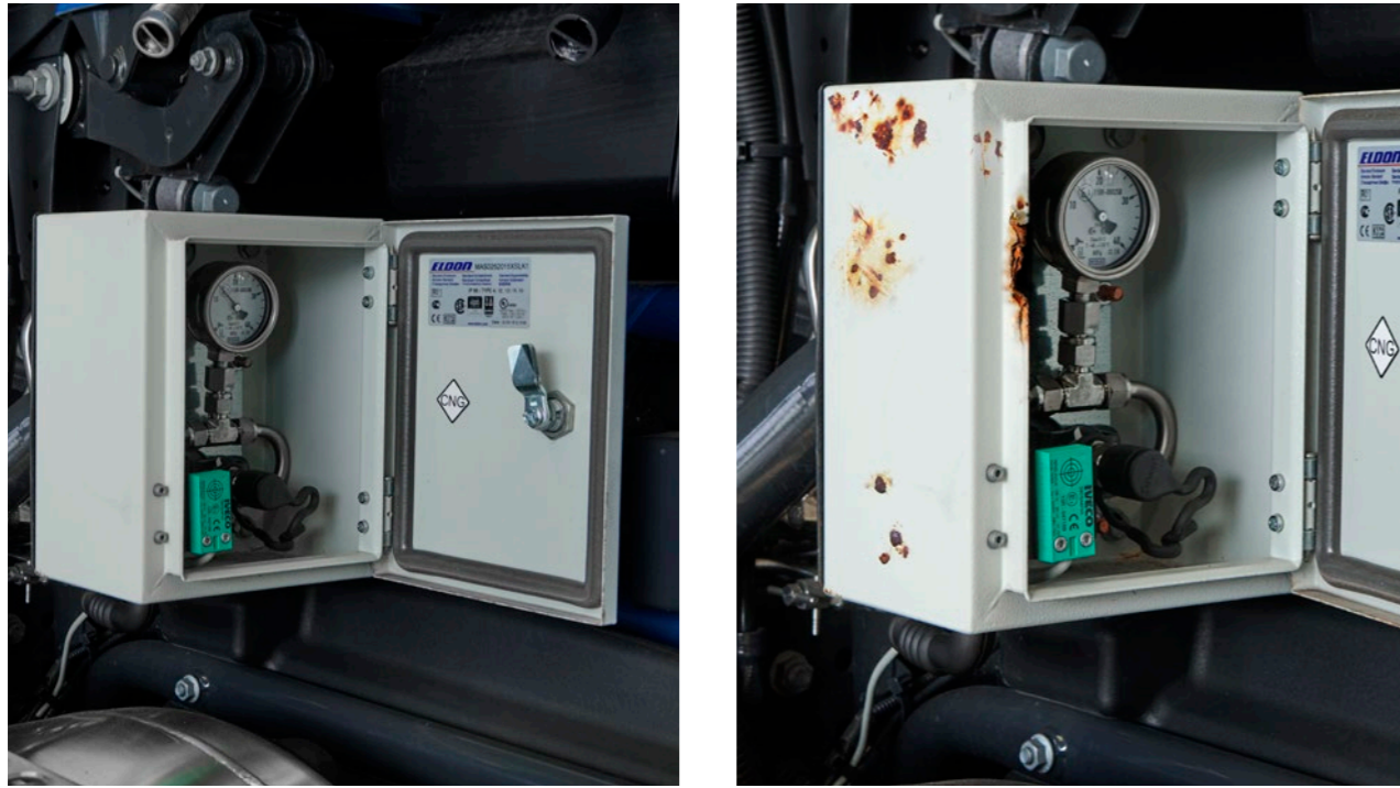
Rouille sur le boîtier de protection de l'orifice de remplissage → remarque sans facturation du dommage.
