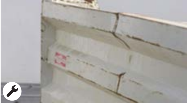
Vervormingen in de rail met een reparatietijd > 1 u economisch verantwoord en als < 10cm
