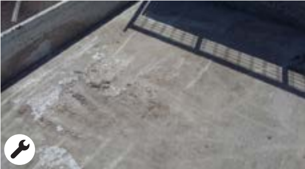
Sporen van beton of chemisch product bedekt ≥ ¼ van het oppervlak van de kipper
