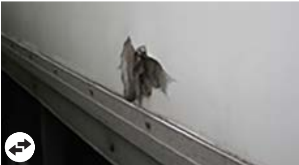
Houten zijpanelen: Beschadigde houten steun ≥ 20 cm
