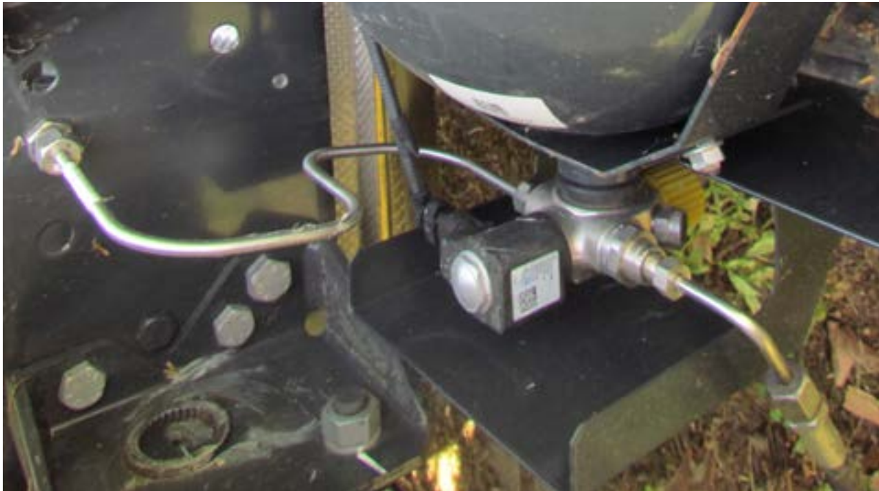
Roest, deuken, breuken en/of krassen • vergoeding voor vervanging van leidingen.
